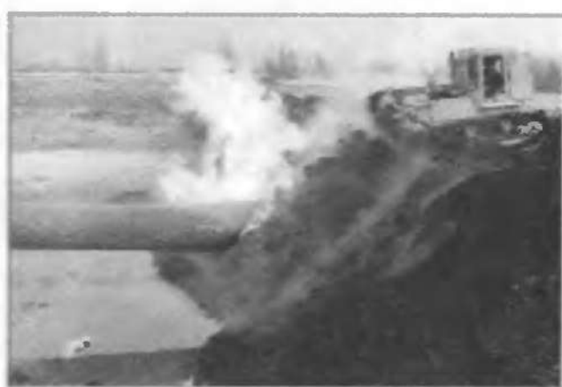
Авария на химически опасном объекте. Мощный взрыв повредил участок газопровода «Пермь — Горький». Ремонтно-восстановительные работы на месте взрыва. 10 декабря 2002 г.
